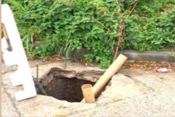
"Boca de cloacas rota en Saavedra y Sivori, un peligro para los transeúntes y autos" escribe Walter.
